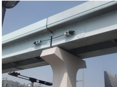
■橋桁の落下を防ぐ落橋防止装置
