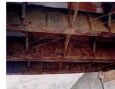
鋼部材の腐食
