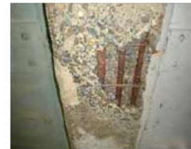
コンクリート部材の剥離・鉄筋露出
